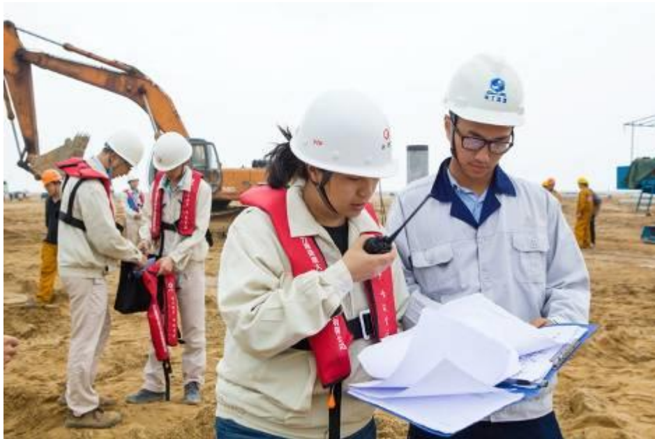
格力地产员工在港珠澳大桥珠海口岸建设现场进行工程管理
